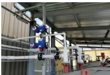
Промышленные полимерные трубопроводы
